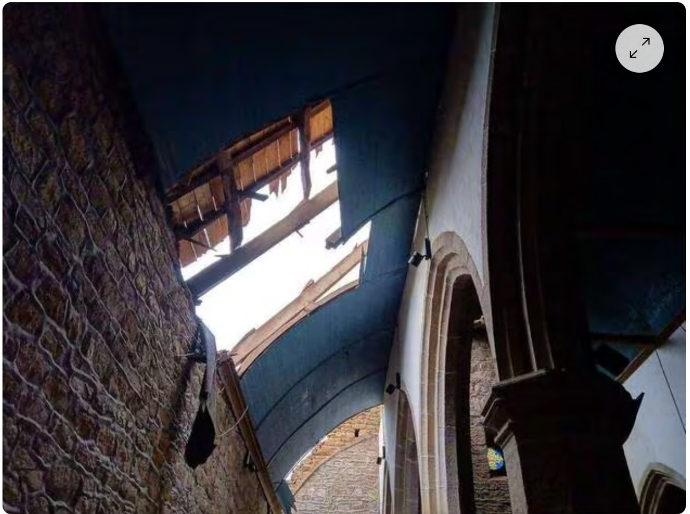
La toiture de la chapelle (vue de l'intérieur) avant le bâchage pour empêcher la pluie d'infiltrer les murs. | FONDATION DE FRANCE
